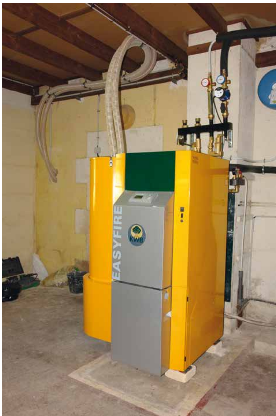
L'Easyfire de KWB, installée à 15 m de son silo.
